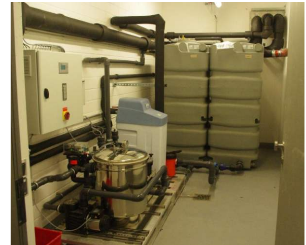
Beispiel: Betriebssystem FF-K mit Pufferspeichern FF-R Foto AGU
